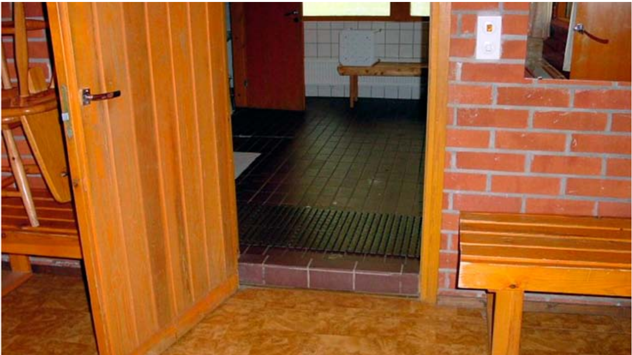
Rakenteellisesti kunnossa, mutta haittaa liikuntarajoitteisten avustamista saunatiloihin.
