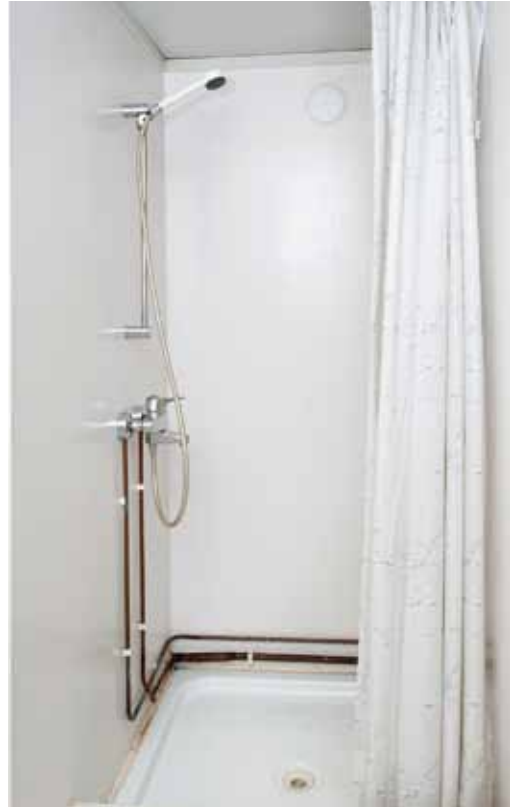
Rakennustyömaan peseytymistila on varustettu suihkulla.
